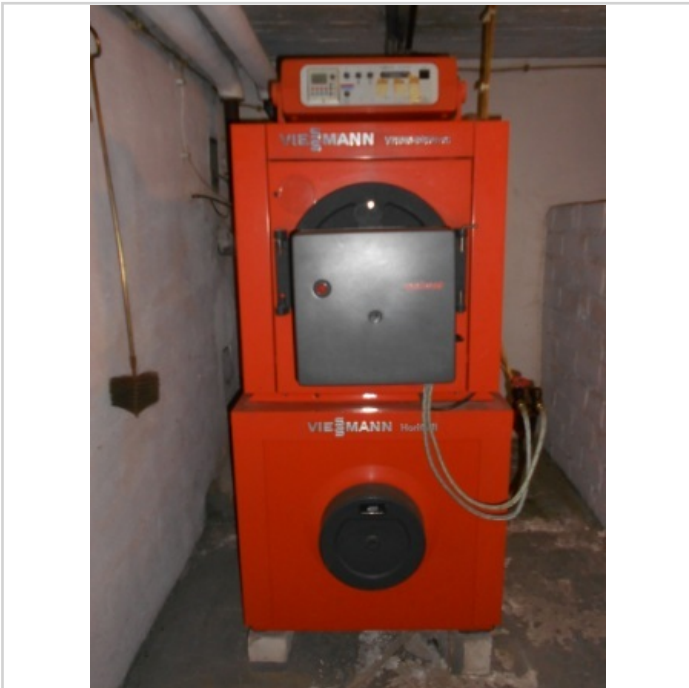
Heizung mit Warmwasserspeicher
